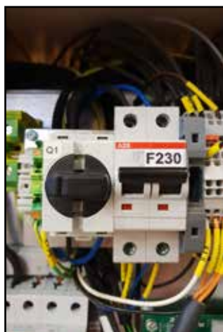
Main switch Q1
